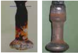
Pasador corroído sin manguito de zinc Pasador con manguito de zinc
